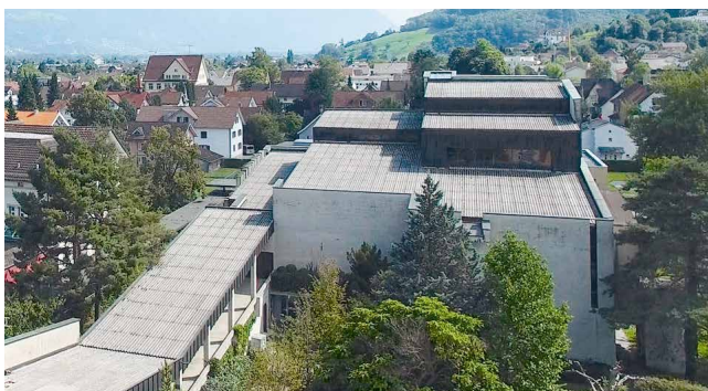
Unser «Sorgenkind» – die Dachflächen der Herz-Jesu-Kirche Buchs
